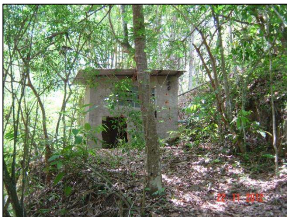
Figura 12 – Estação Elevatória de Água Bruta no Horto Municipal
