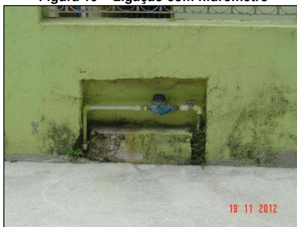
Figura 19 – Ligação com hidrômetro
