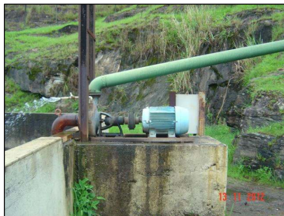
Figura 13 – Estação Elevatória de Água Bruta Nelson Carneiro
