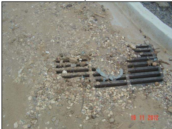
Figura 31 – Boca de lobo com problemas de limpeza
